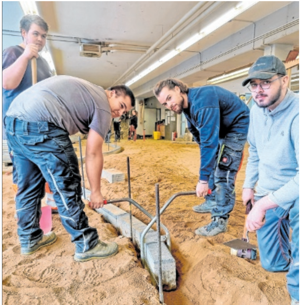
Angehende Straßenbauer beim praktischen „Training“ in einer Ausbildungshalle des AWZ Bau in Fellinghausen – ein Verkehrskreisel soll entstehen. Foto: Björn Hadem
